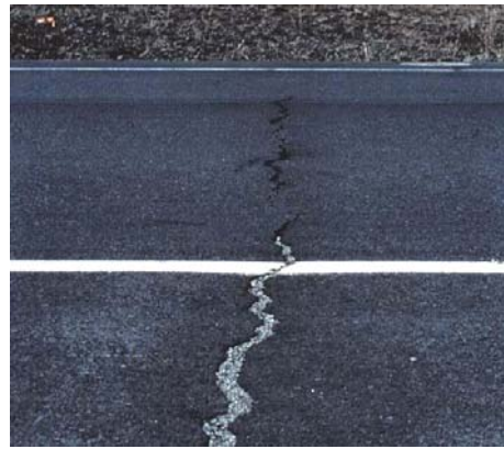
(d) Transverse cracking
